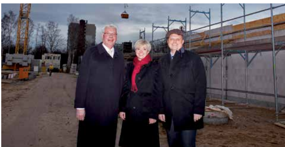
Klosterkammer-Präsident Hans-Christian Biallas und die LIEMAK-Geschäftsführer Sylva Viebach und Dr. Matthias Nagel besichtigen die Baustelle am Lenbachplatz (von links). Foto: Claire Winkler
