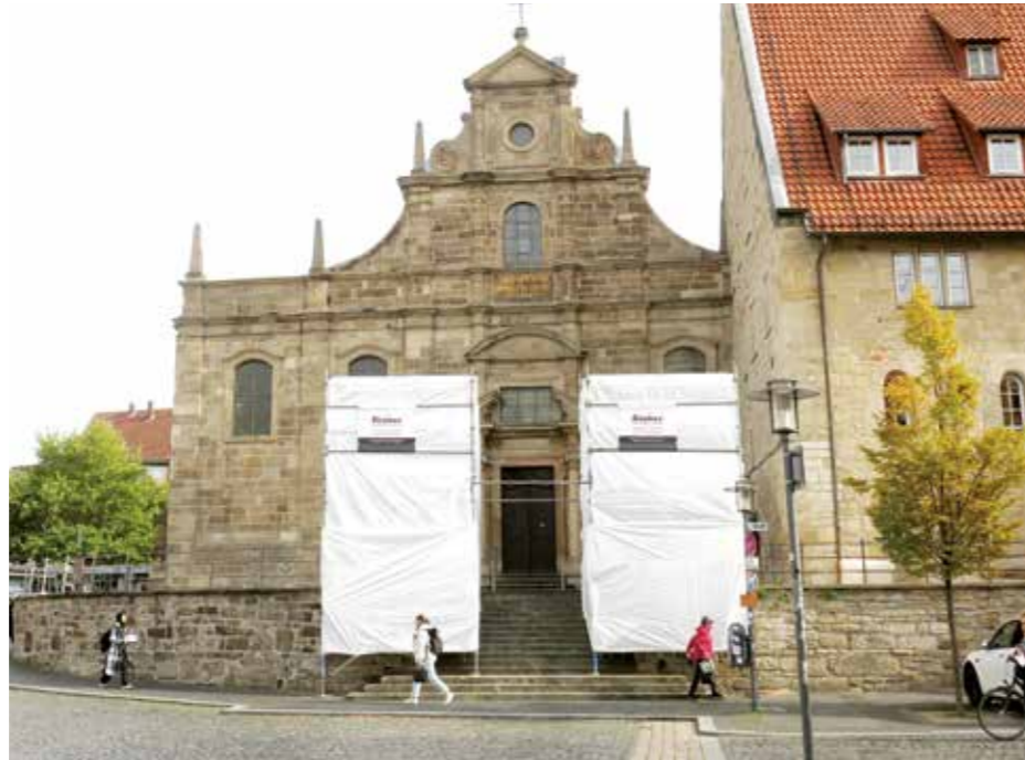
Nach jahrhundertelangem Aufenthalt im Freien: Verhüllte Skulpturen vor der Heilig-Kreuz-Kirche in Hildesheim während der Arbeiten. Fotos: Johannes Mädebach
